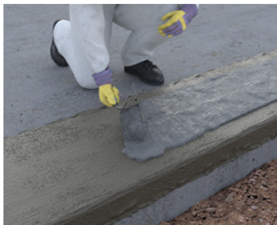
Abb. 10.4: Auftragen des Mörtelbettes der Mörtelgruppe III in Steinbreite auf der mineralischen Dichtungsschlämme
