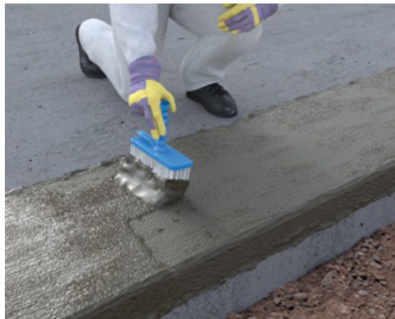
Abb. 10.3: Auftragen der mineralischen Dichtungsschlämme in 2-facher Schlämmfolge frisch in frisch mit einer Bürste
